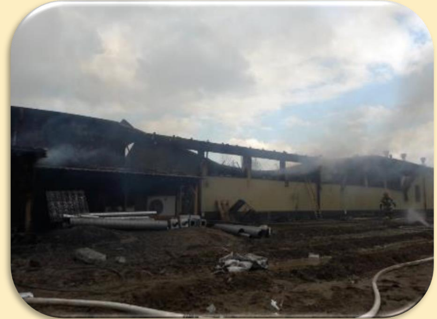
Pożar budynku handlowo usługowego w Gniewinie - 5.04.2018 r. - Brak osób poszkodowanych – 13 zastępów PSP i OSP , 47 ratowników
