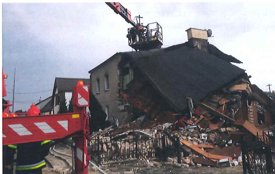
Zdjęcie 28. Wybuch gazu w budynku – wrzesień miejscowość Choczewo.
