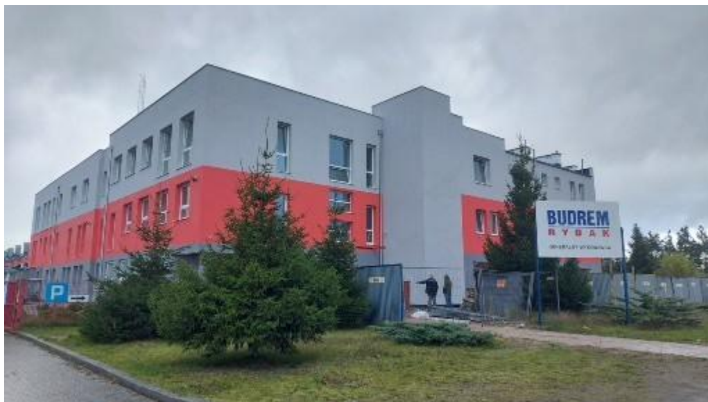
Zdjęcie: Przebudowa budynku Jednostki Ratowniczo – Gaśniczej nr 1 KP PSP w Wejherowie - grudzień 2022
